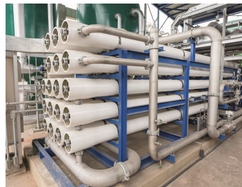
Оборудование для водоподготовки
