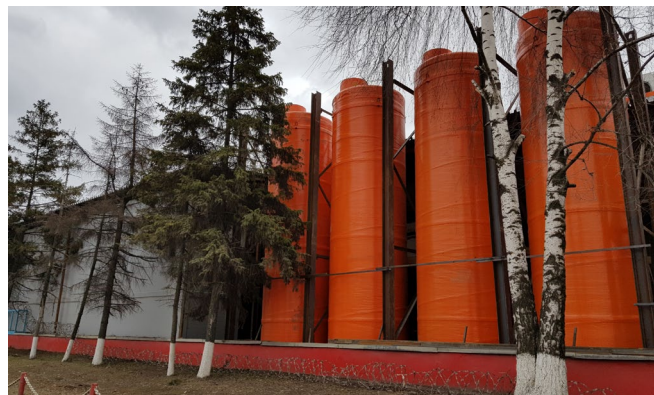
Производство, монтаж системы биологической очистки HELIX в аэропорт Шереметьево, терминал D, Москва
